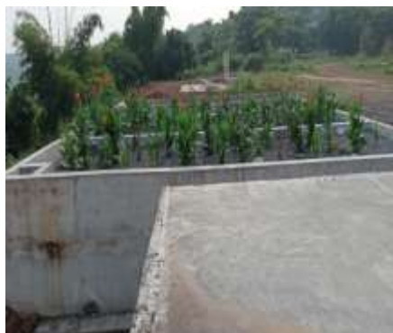
Fig. 8. A new STP
